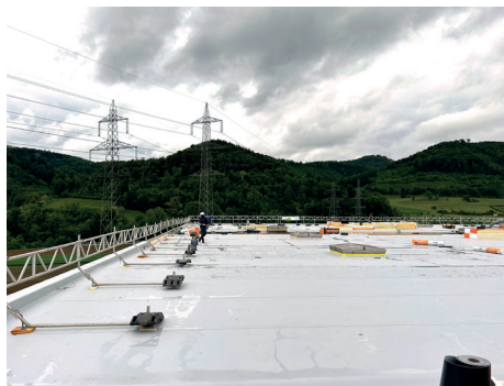
Temporäre Absturzsicherung während Bauphase
